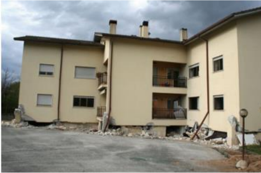
Αστοχία μαλακού ορόφου, σεισμός L'Aquila, 2009.
