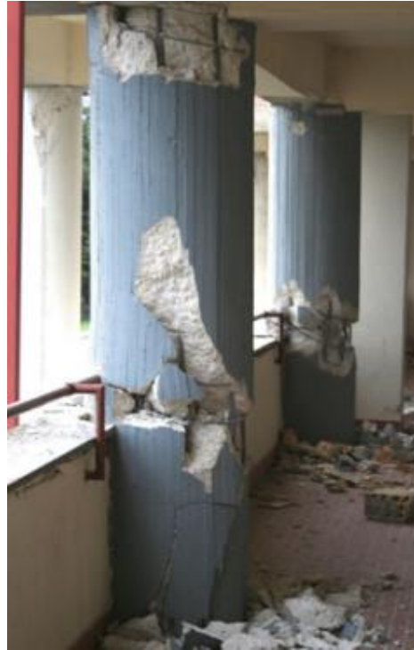
Διατμητική αστοχία κυκλικού υποστυλώματος
