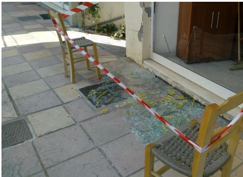
Βλάβες σε υαλοστάσιο
