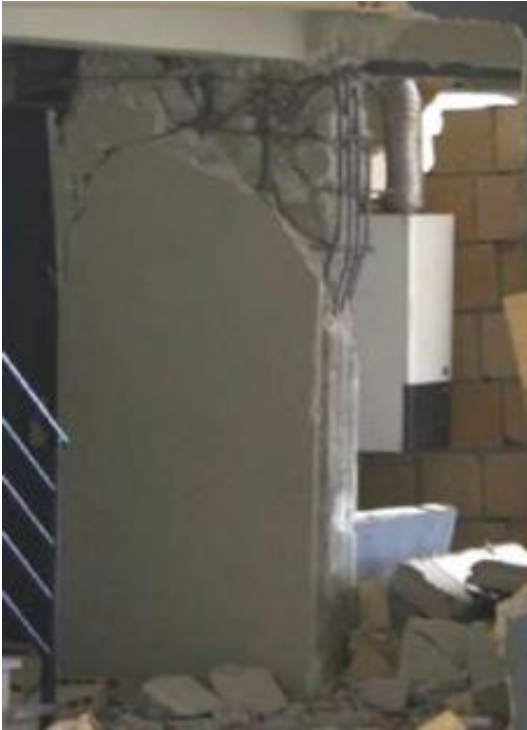
Διατμητική αστοχία ορθογωνικού υποστυλώματος
