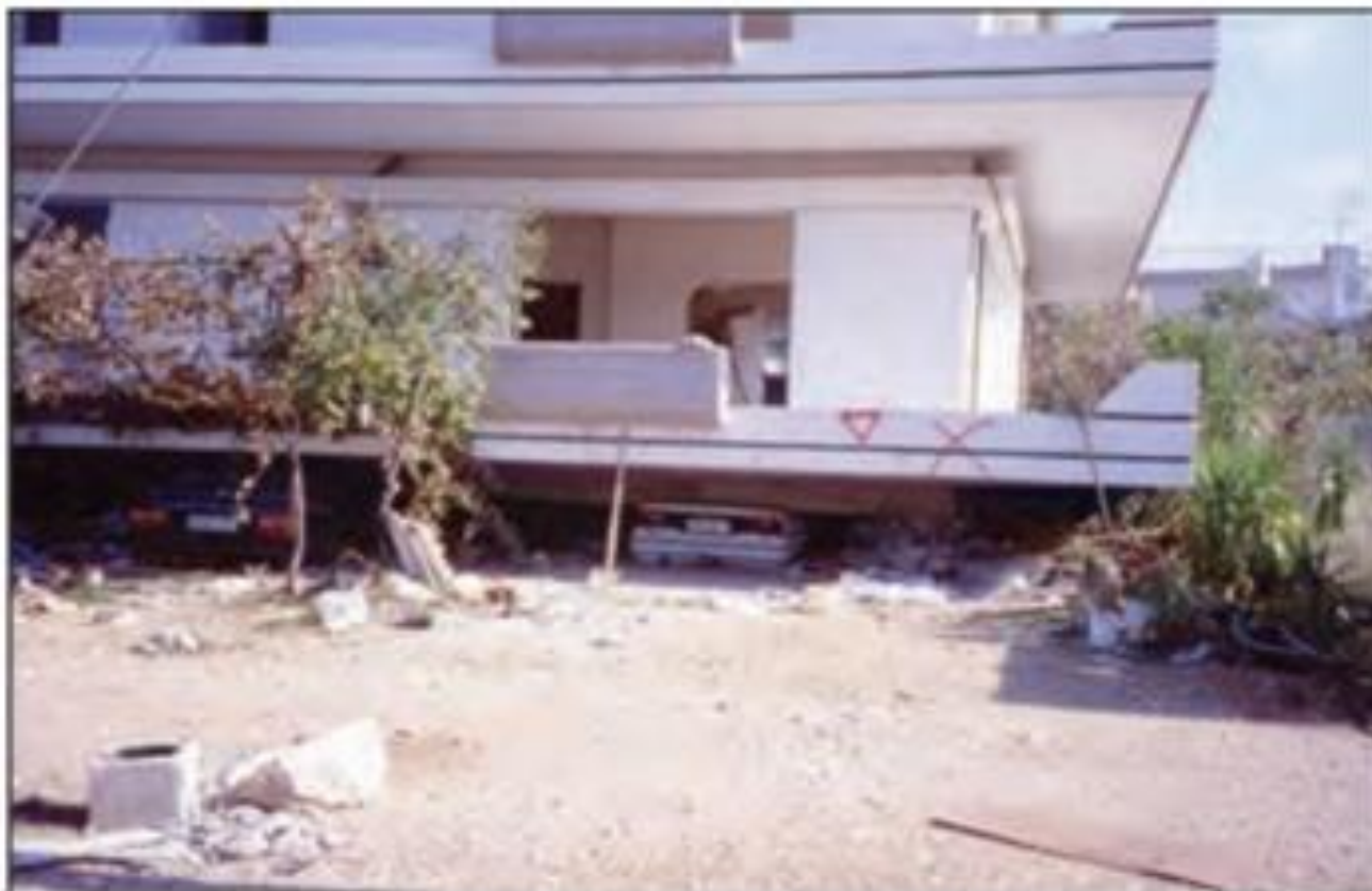
Αστοχία μαλακού ορόφου, σεισμός Αιγίου, 1995.
