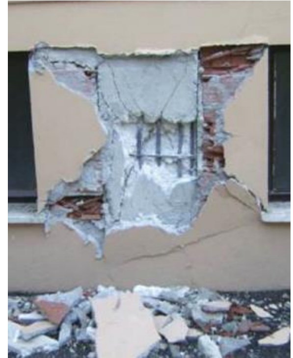
Διατμητική αστοχία κοντού υποστυλώματος
