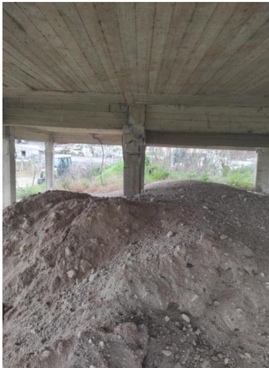
Αστοχία μαλακού ορόφου
