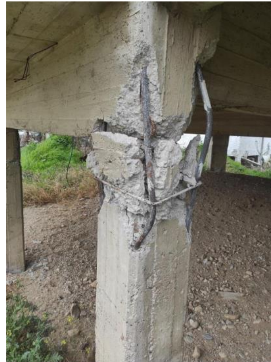
Αστοχία κεφαλής υποστυλώματος
