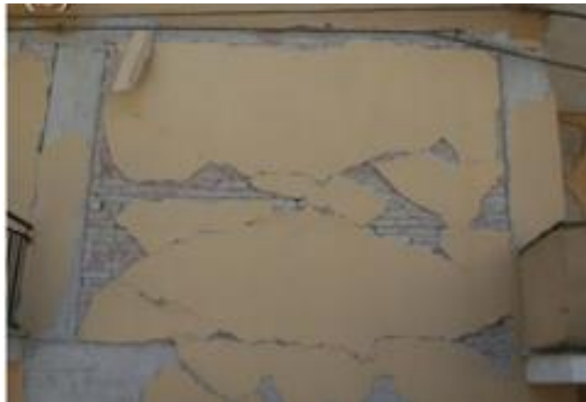
Διαγώνιες ρωγμές σε τοιχοπληρώσεις.
