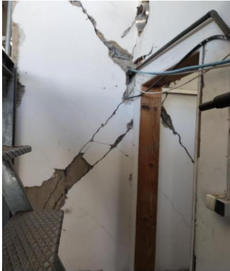
Διατμητική αστοχία σε τοίχωμα μαλακού ορόφου
