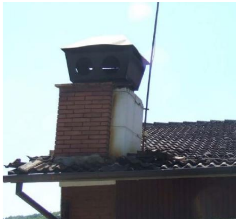
Βλάβες σε καμινάδα
