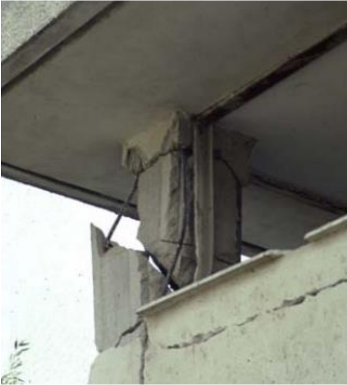
Αστοχία κοντού υποστυλώματος
