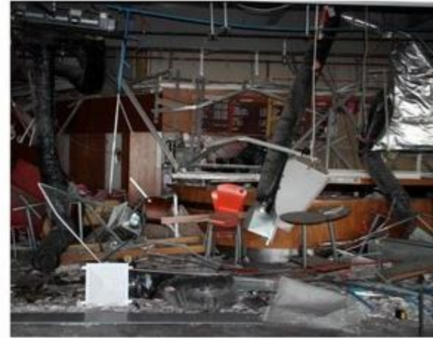
Βλάβες σε χώρους αεροδρομίου, 2010 Maule, Chile earthquake
