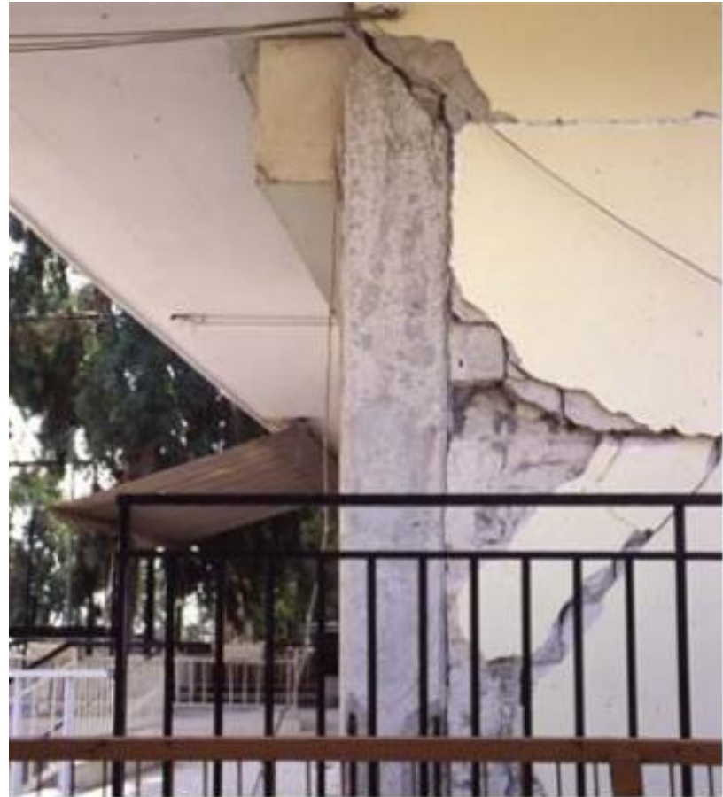
Διαγώνια ρηγματώση εξωτερικού κόμβου
