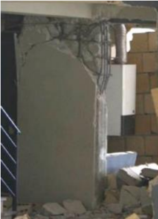
Διατμητική αστοχία ορθογωνικού υποστυλώματος
