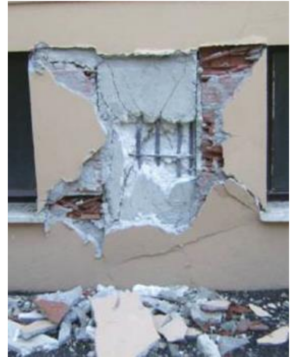
Διατμητική αστοχία κοντού υποστυλώματος
