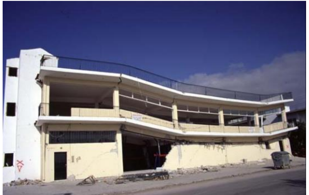
Αστοχία σειράς κοντών υποστυλωμάτων
