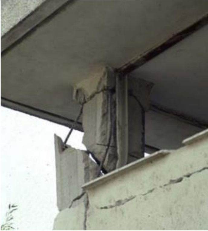
Αστοχία κοντού υποστυλώματος
