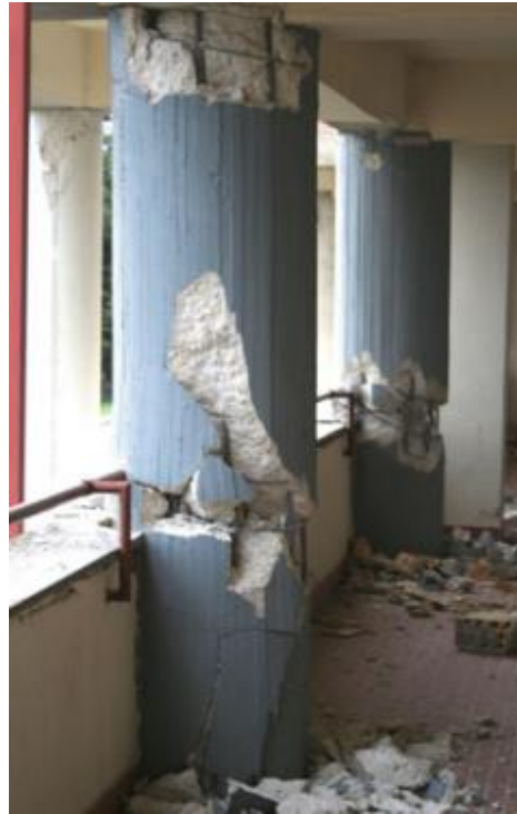
Διατμητική αστοχία κυκλικού υποστυλώματος
