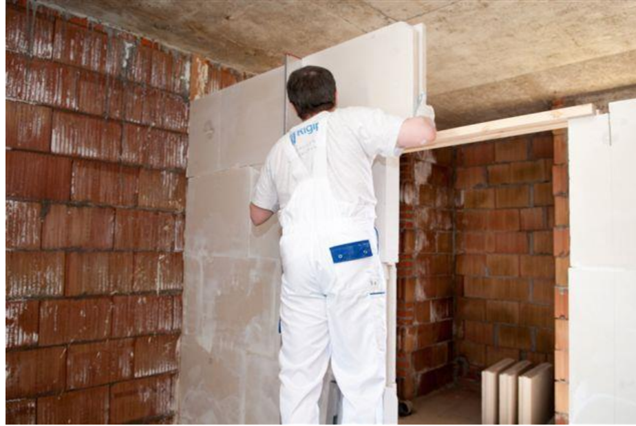
" Ściana działowa Rigiroc, otwór drzwiowy. " by PiotrDabkowski - Own work. Licensed under CC BY-SA 3.0 via Wikimedia Commons
