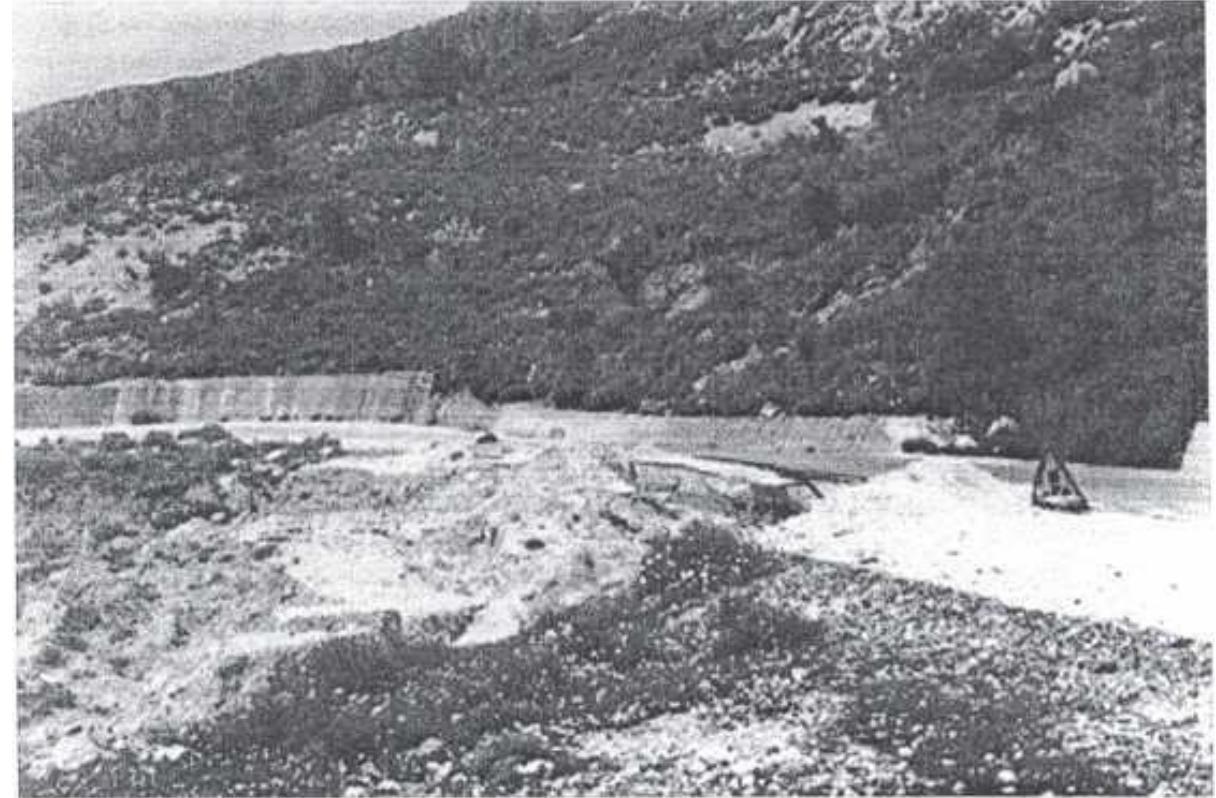
Εικόνα 10. Πεταλοειδής ολίσθηση σε πρανή ήπιων κλίσεων
