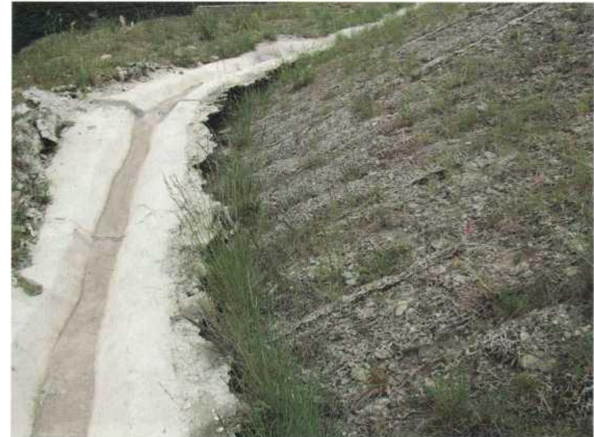
Εικόνα 35. Κατασκευαστική αστοχία τάφρων αναβαθμών σε όρυγμα.
