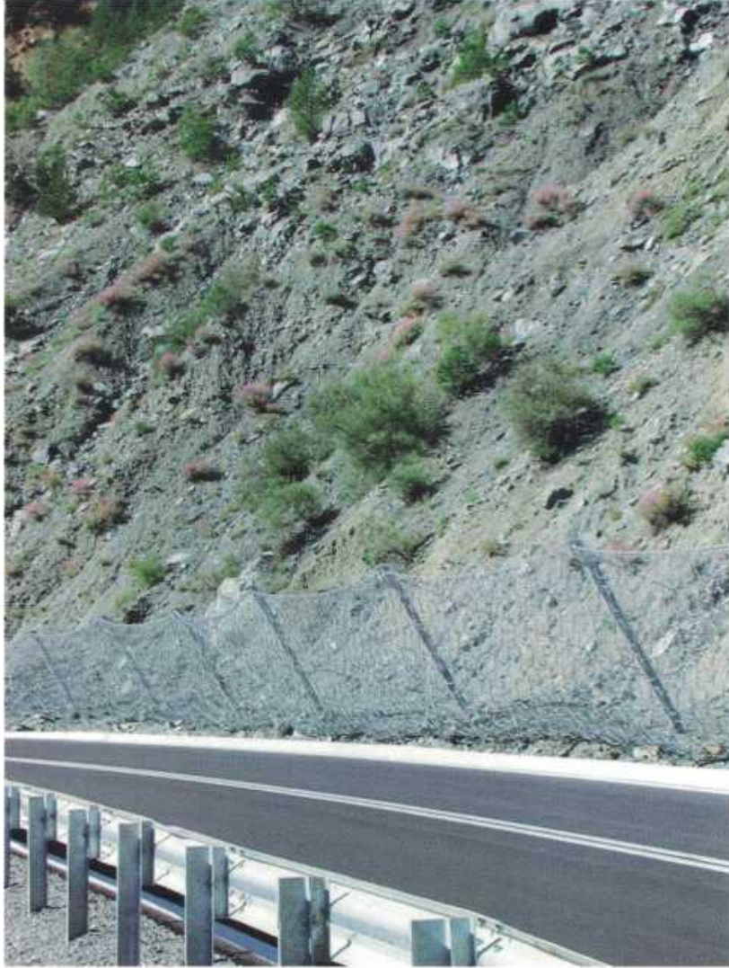
Εικόνα 38. Μεταλλικός φράχτης παγίδευσης καταπτώσεων.
