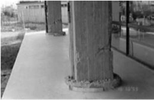
Ρηγμάτωση υποστυλώματος από κάμψης
