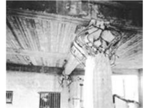
Αστοχία με διακοπή της συνέχειας κρίσιμη περιοχή υποστυλώματος και κόμβου. Κατακόρυφη συνιστώσα
