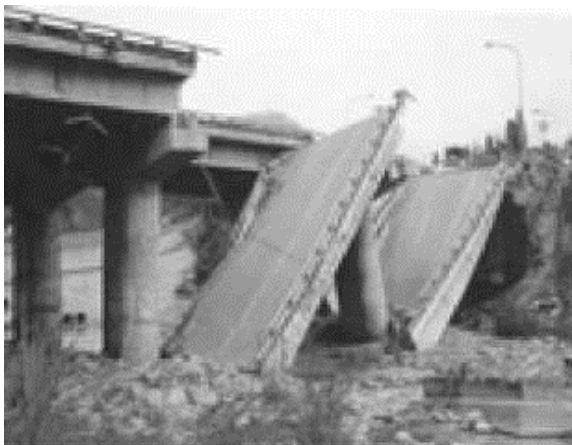
Αστοχία λόγω απώλειας στήριξης
