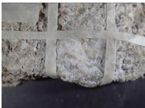
Σχήμα 7.91. ΑΚ 4000. Μετά την επέμβαση καθαρισμού. Παρατηρείται φθορά του υποστρώματος και ατελής καθαρισμός.
