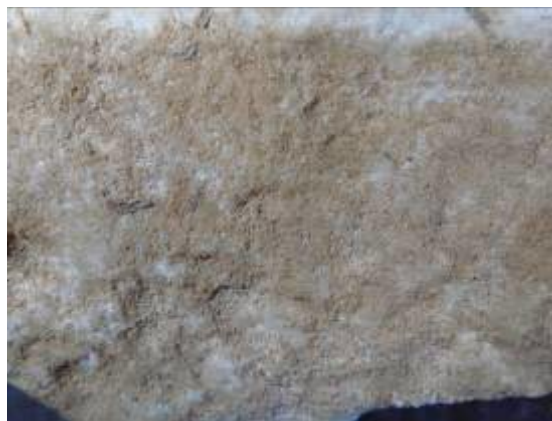
Σχήμα 5.133. ΑΚ 4427. Περιοχές εμποτισμών μετά την αφαίρεση του εδαφικού υλικού. Λεπτομέρεια.
