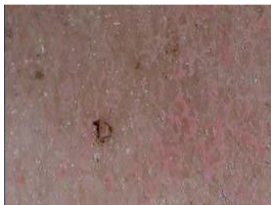
Σχήμα 2.38 Ειδική περίπτωση II. AK516. Το υλικό που εντοπίστηκε στη θέση αυτή έχει τη μορφή διαβρωμένου επιστρώματος.
