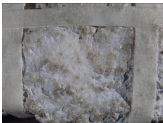
Σχήμα 7.92. ΑΚ 4000. Μετά τον καθαρισμό. Έντονη φθορά του υποστρώματος.
