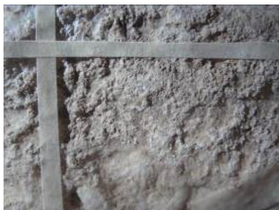
Σχήμα 7.90. ΑΚ 4000. Λεπτομέρεια περιοχής πριν τον καθαρισμό
