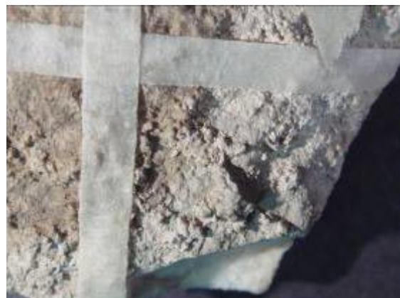
Σχήμα 7.129. ΑΚ 4215. Περιοχή 3 μετά τον καθαρισμό. Δεν παρατηρείται μείωση του πάχους της ασβεστιτικής κρούστας
